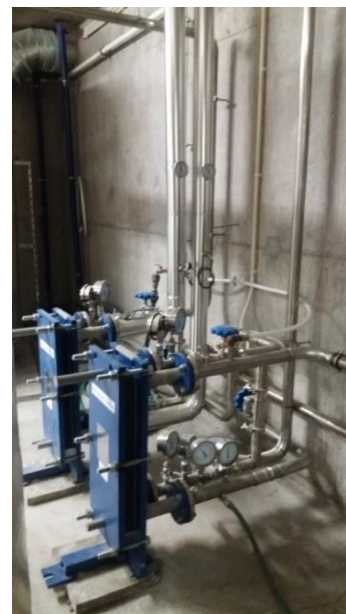
Ilustração 8: Permutadores de placas
